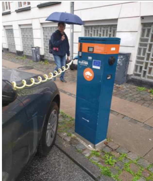
2019. 9.30.(월) 도보 이동 중 전기자동차 충전시설
