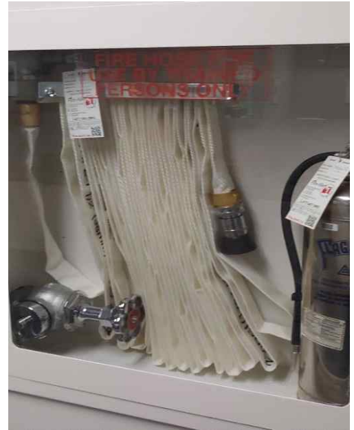
RESO 내에 설치된 소화전
